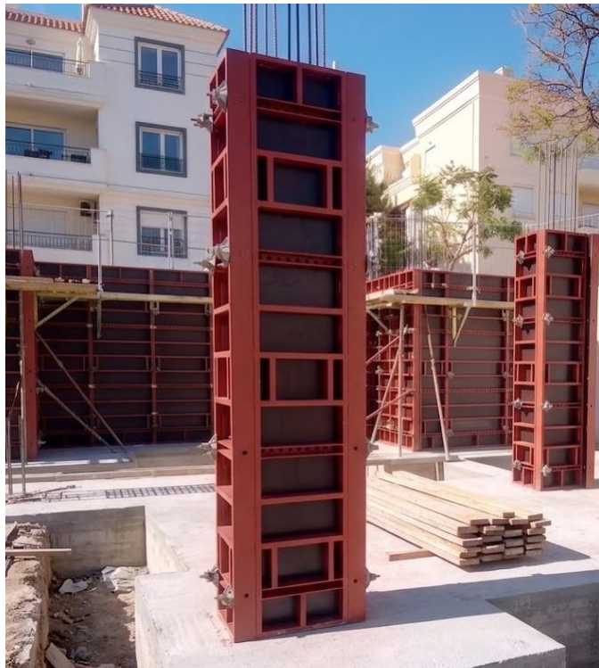
Sistema en obra
