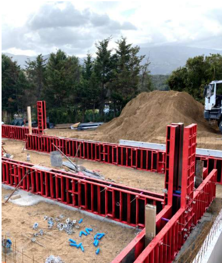
Sistema en obra
