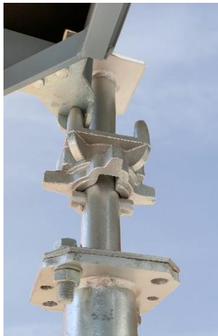
Tête de détrincement bloquée
